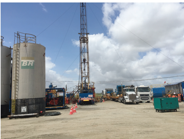
Figura 1 – Sonda, tanque cilíndrico e bombas
