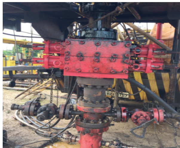
Figura 2 – BOP de tubos
