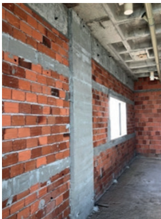
Figura 1 - Bases para suporte contínuas em concreto armado.
