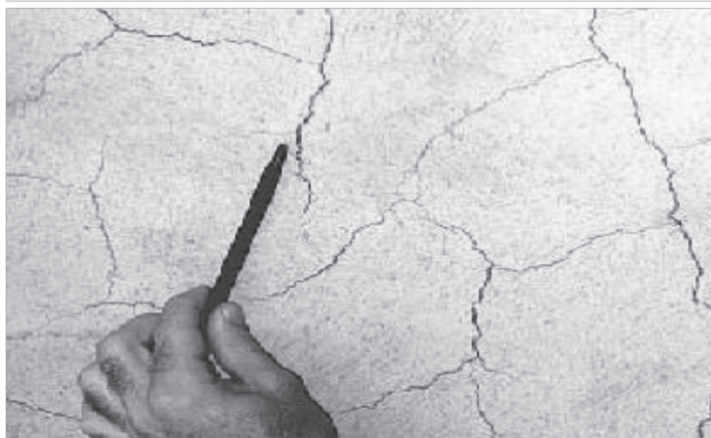
Figura 2 – Fissuras em argamassa de revestimento.
