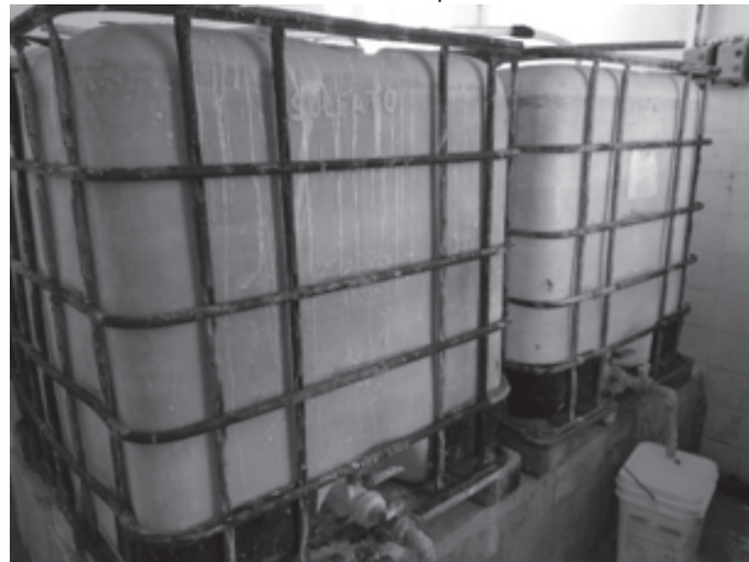
Figura 3 – Tanques de sulfato de alumínio e hipoclorito de sódio
