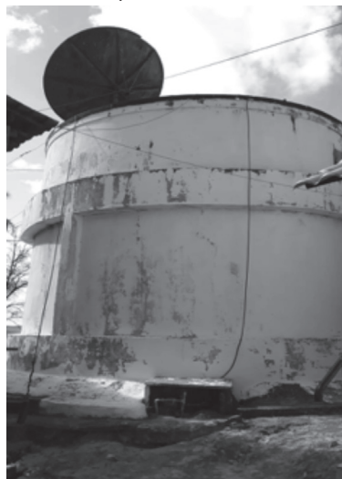
Figura 6 – Reservatório localizado na parte alta da cidade
