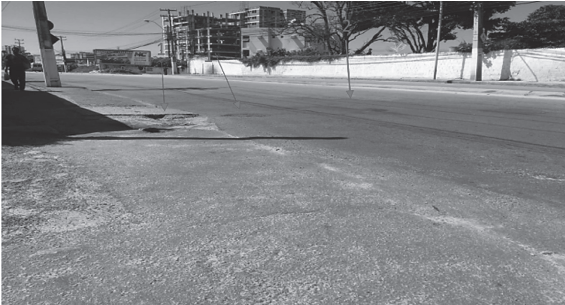
FIGURA 3 - 1) panelas, 2) afundamento, localizado na Av. Comendador Gustavo Paiva, sentido UNIT – Maceió Shopping
