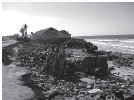
Figura 5 – Muro de arrimo danificado
