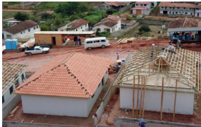
Figura 9 – Telhamento e Kit Solar
