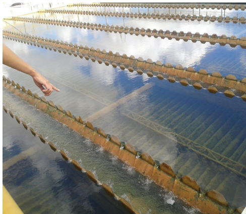
Figura 2 – Estação de tratamento Pratygy
