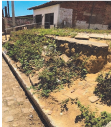
Figura 1 – Calçadas com falta de estrutura e acessibilidade
