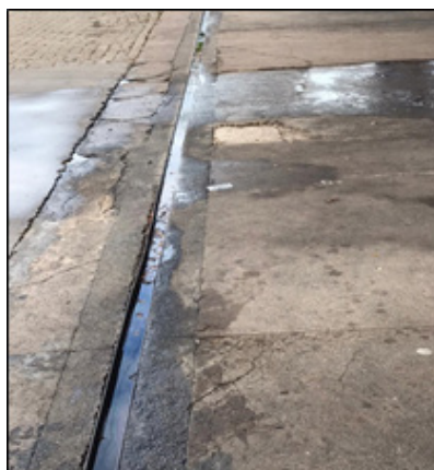
Figura 7 – Transbordo de água de lavagem da pista de abastecimento causada pela obstrução da canaleta
