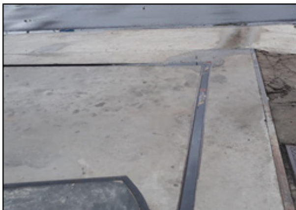
Figura 6 – Transbordo de água da chuva causada pela obstrução da canaleta
