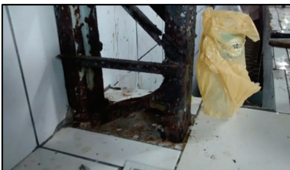
Figura 3 – Pilar sofrendo oxidação
