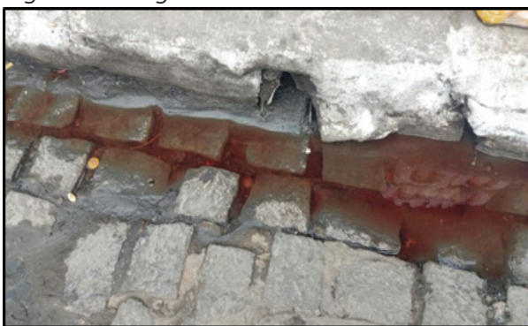
Figura 5 – Esgoto a céu aberto
