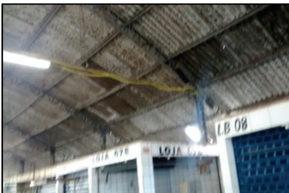
Figura 6 – Coberta e instalações elétricas precárias
