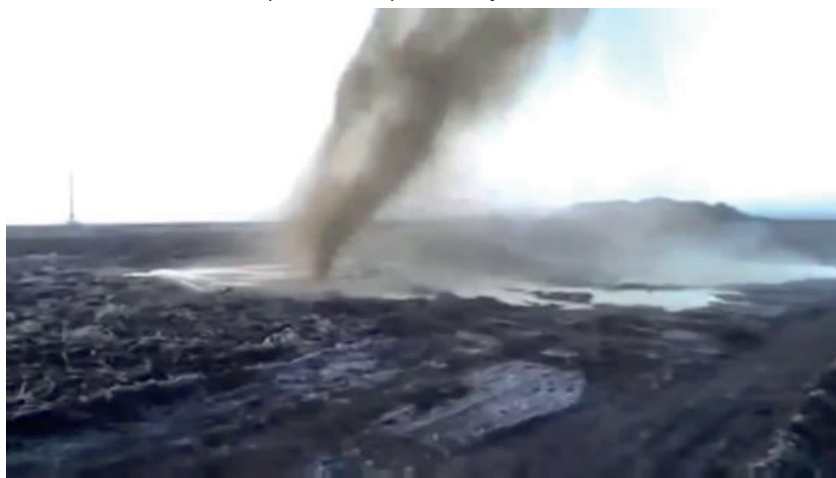
Figura 12 – Acidente Causado por uma perfuração direcional
